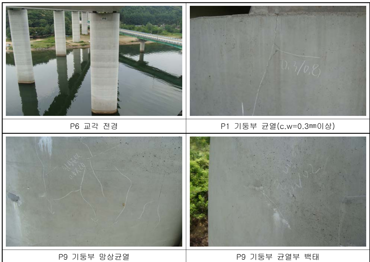
【사진 3.4】 교각 손상현황
