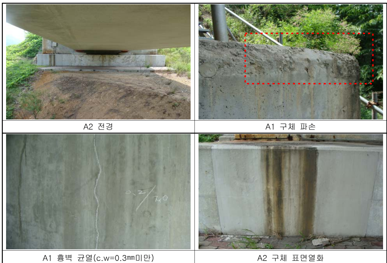
【사진 3.3】 교대 손상현황
